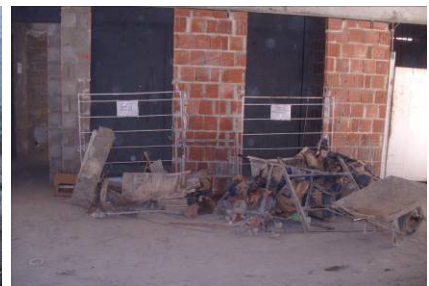
Resíduos espalhados na obra
