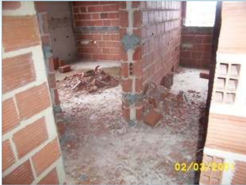
Resíduos de alvenaria – desperdício de material (Fonte: SENAI-BA)
